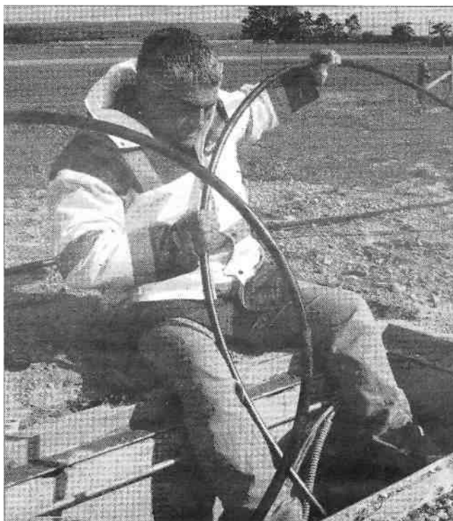
• La pause du câble a nécessité l'intervention de 8 personnes.
